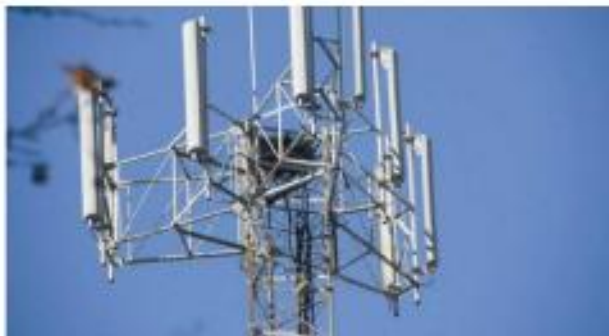
Εικόνα 2: Κεντρικός σταθμός βάσης (κεραία)
